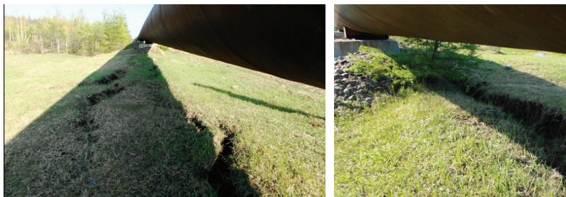
Рис. 1. Морозобойные трещины на трассе водовода
